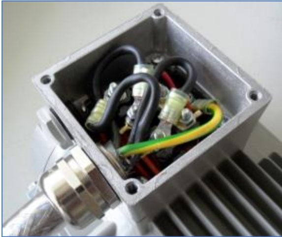
Afbeelding 4: motor connection box
